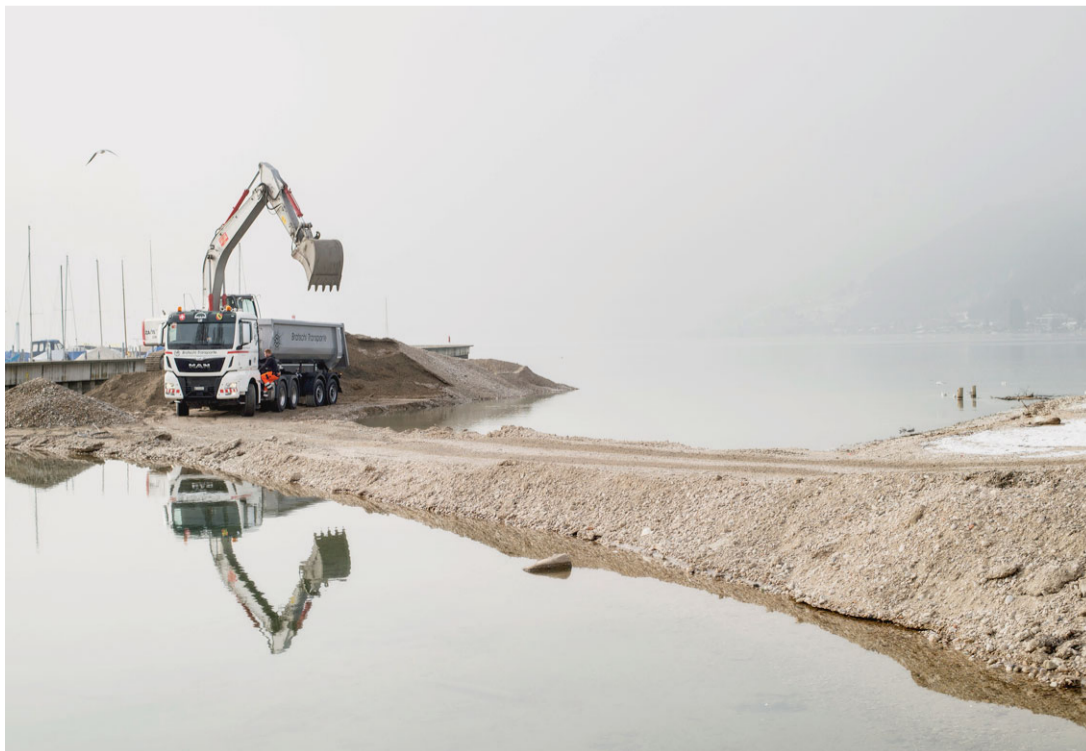
Noch rund zwei Wochen dauern die Arbeiten, um den Kies bei der Einmündung der Schüss in den Bielersee auszubaggern. Die Kosten belaufen sich auf mehrere 10 000 Franken. Anita Vozza
